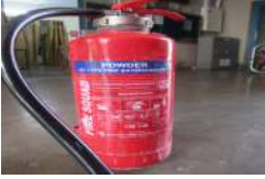
Extinguisher 3.JPG 5 MB
